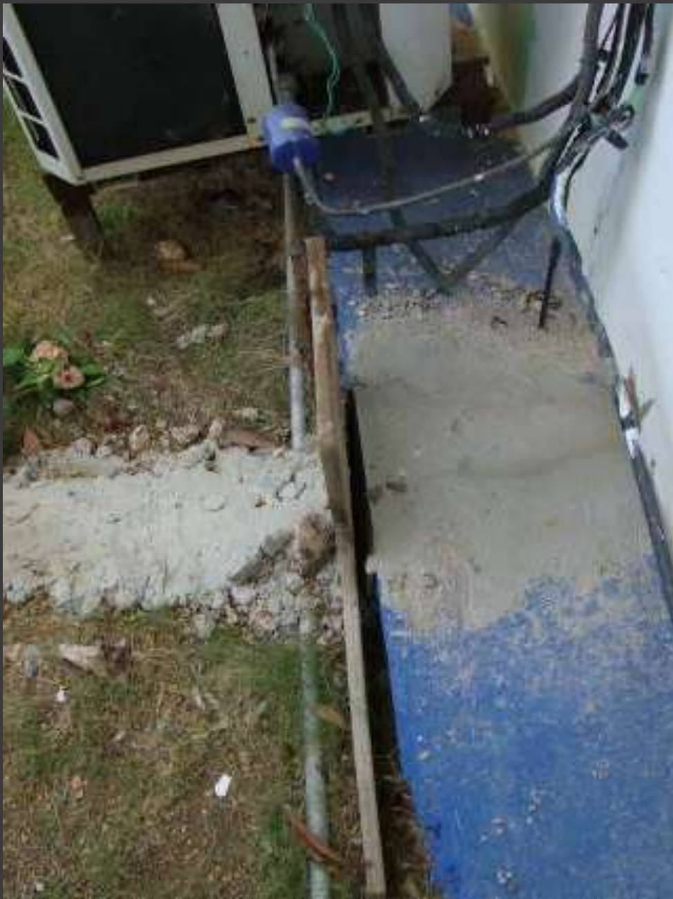
Canalización para entrar al cuarto de telecomunicaciones del Núcleo de Sucre Edif. IOV
